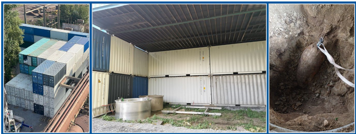
Abbildung 6: Schutzbauwerk aus Containern, Ringeverbau zur Bergung der Munition aus der Tiefe (Foto: KBD)
