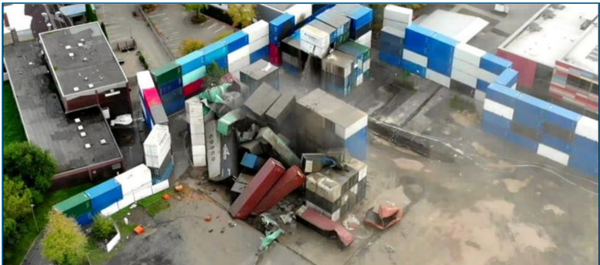
Abbildung 7: Zerstörung nach der Sprengung (Foto: Stadt Göttingen)
