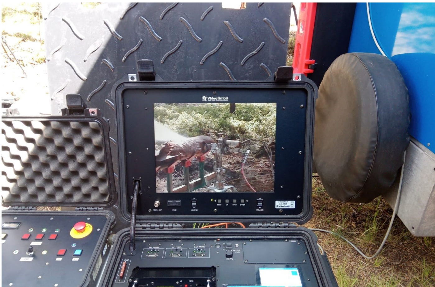
Videoüberwachung der Schneidvorgänge
